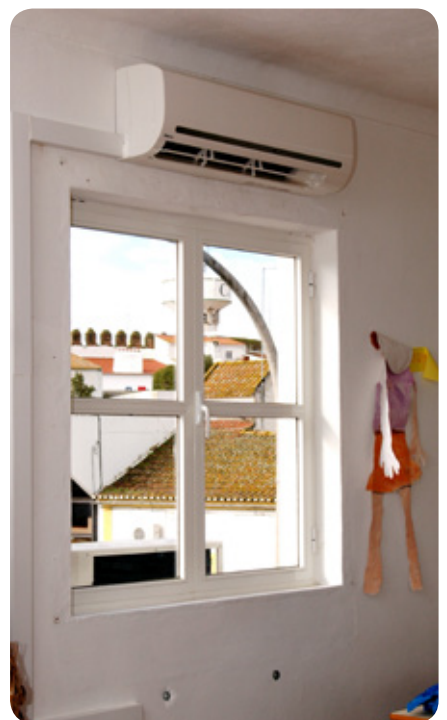
> Instalação de Ar Condicionado sala do "1º Ano" Monforte
